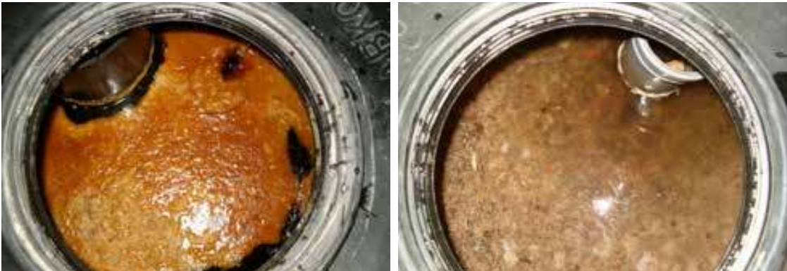
Şekil 2: Dolu yağ ayırıcıların üstten görünüşü
